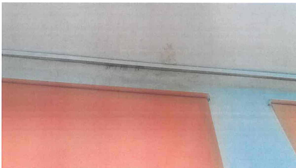
Rysunek 5-8 Zacieki występujące w miejscach niewłaściwego zakotwienia piorunochronów na najwyższej części budynku.
