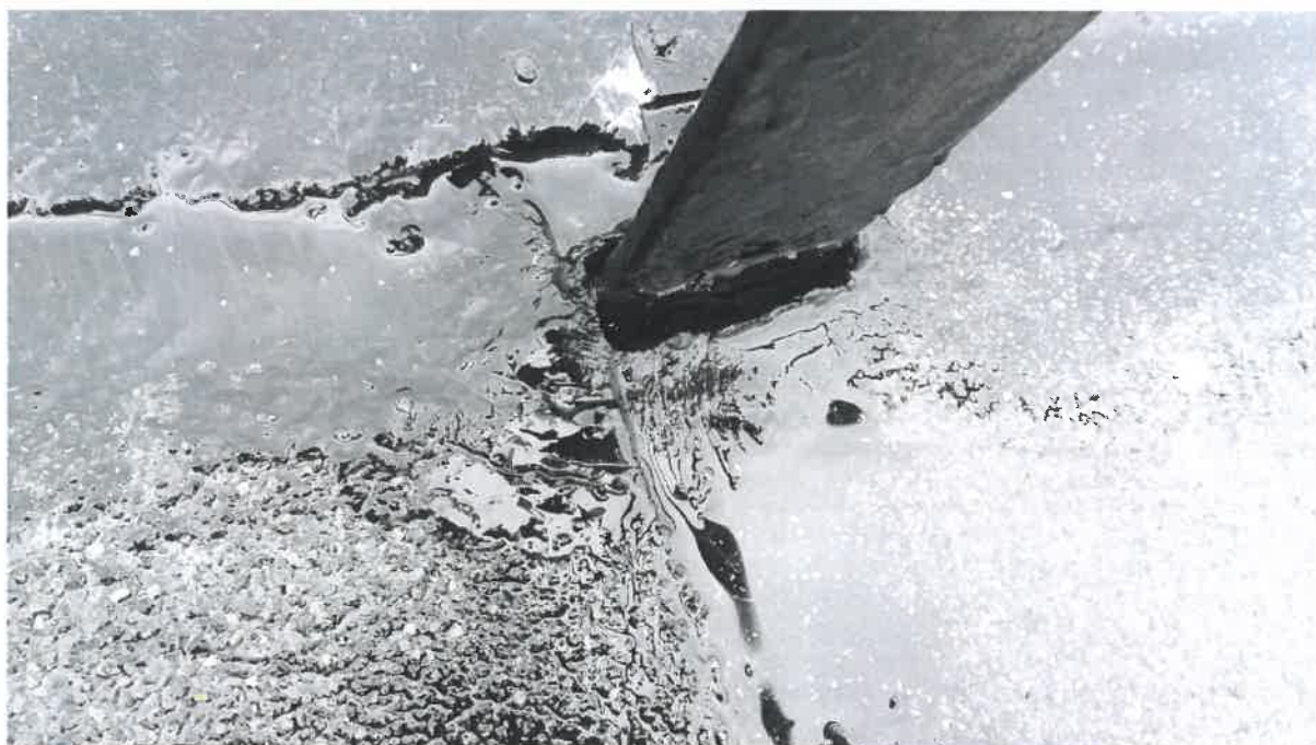
Rysunek 5-6 Kotwa do piorunochronu na zewnętrznych krawędziach konstrukcji dachu z widocznymi szczelinami przy łączeniu z papą na najwyższej części budynku.
