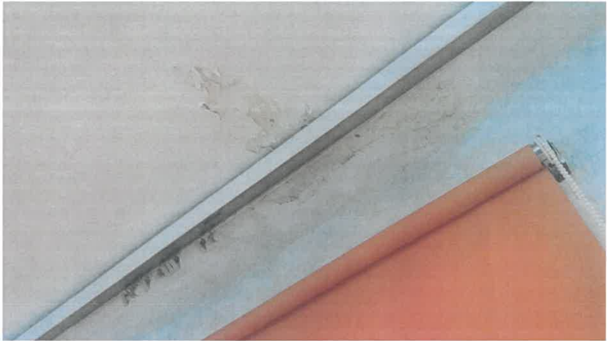
Rysunek 5-9 Zacieki występujące w miejscach niewłaściwego zakotwienia piorunochronów na najwyższej części budynku.
